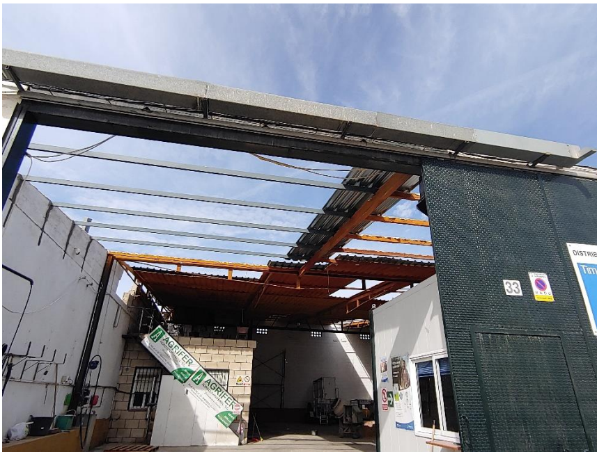
Paradas. Tejado de nave (categoría AB) casi destruido. IF \geq 1
