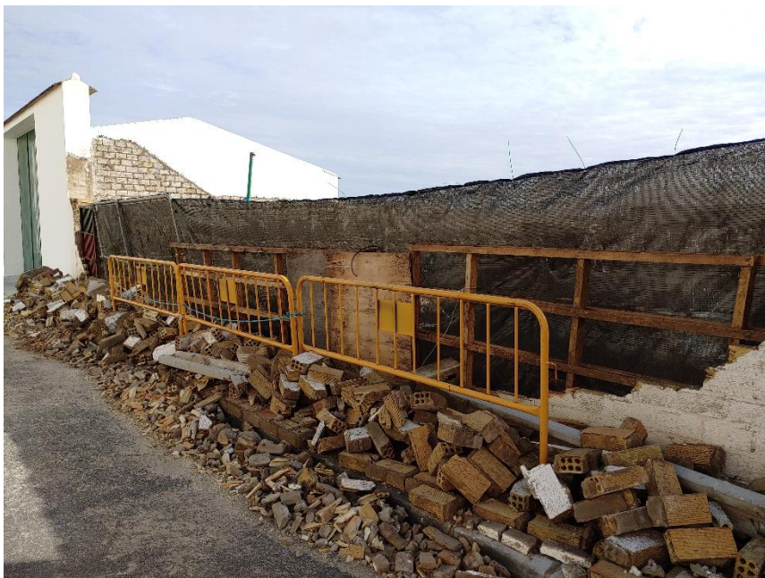
Paradas. Muro de ladrillo muy débil (categoría Z) casi derruido. IF \geq 1
