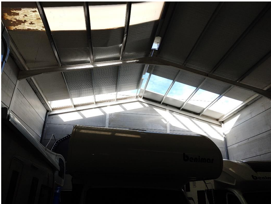
Pol. Industrial Los Alberos de Paradas. Daños en naves (construcción tipo C, menos de 2/3 de destrucción). Categoría IF 1.5
