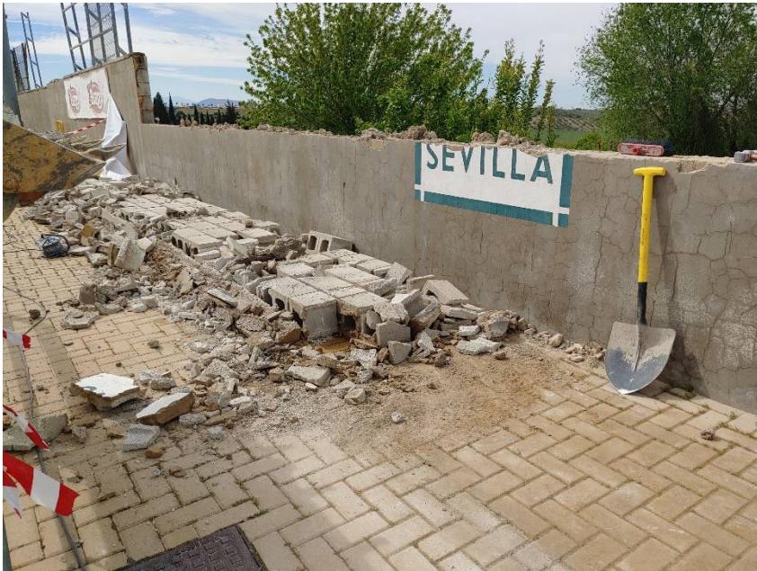
Paradas. Campo de fútbol. Muro aislado de bloques de hormigón sin relleno ni refuerzo (categoría).parcialmente derruido. IF1.
