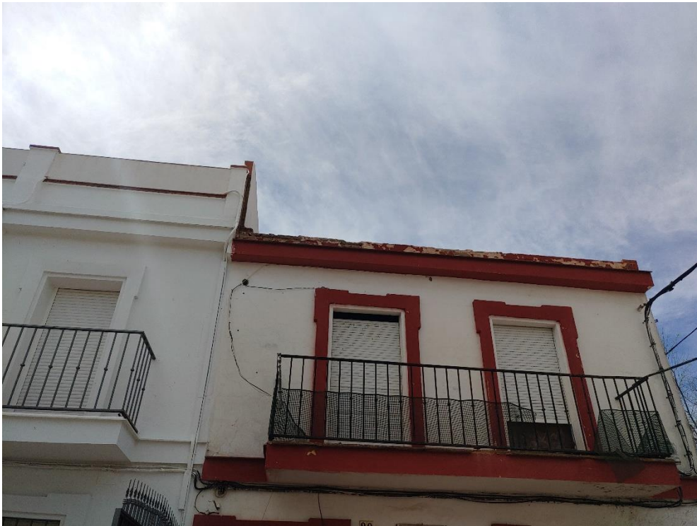
Marchena. Murete de azotea (categoría A) derribado. IF \geq 1.5
