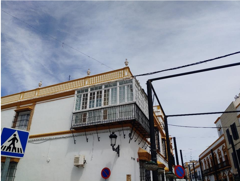
Marchena. Daños en cornisa (categoría TS). IF 1
