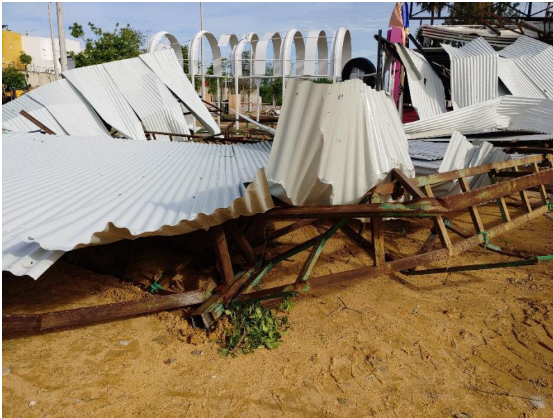
Paradas. Estructuras de casetas (Categoría A) derribadas. IF \geq 1.5
